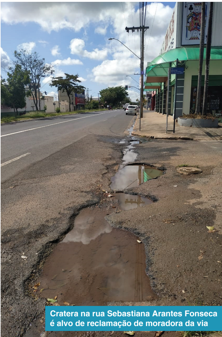
Rua no bairro Karaíba tem três buracos próximos um dos outros
